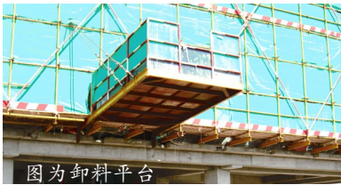
图为卸料平台
